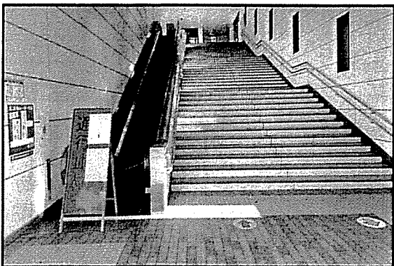
相原駅東口エスカレーターの利用停止時の様子。
