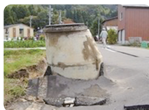
地震により隆起した道路上のマンホール (出典:新潟県長岡市HP)
