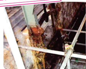
使用開始から50年経過した、污水が流入するゲートの腐食
