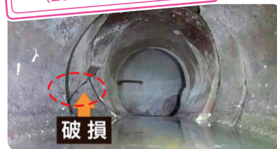
污水管の破損箇所
