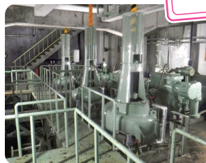
メンテナンスを行い稼働させている、1975年製造の污水ポンプ設備
