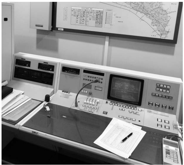
防災行政無線室
