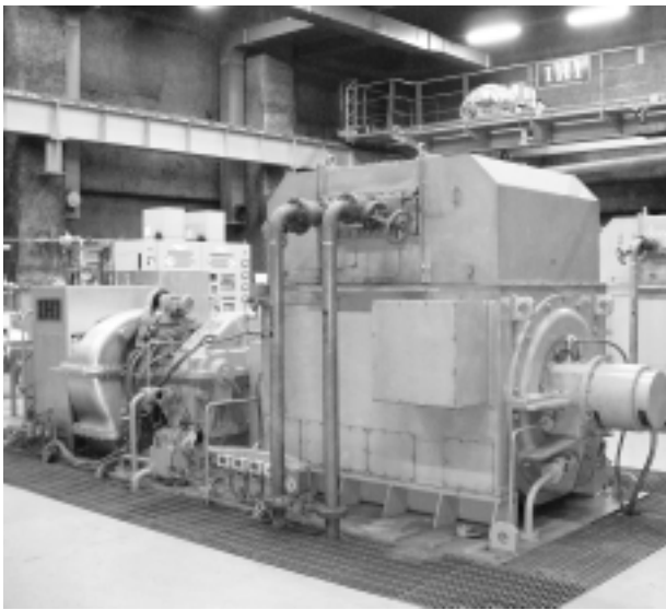
発電システム(清掃工場)
