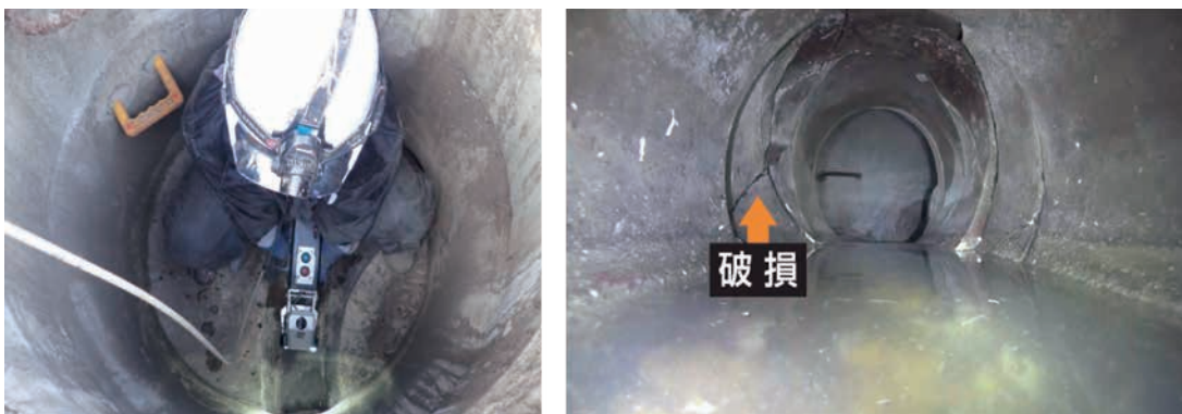
図6-6 スクリーニング調査の状況（左）、破損状況のイメージ（右）
