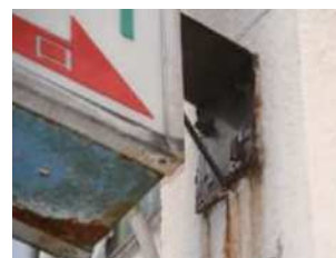
支持金具の腐食
