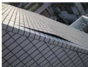
タイル面の浮き
