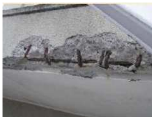
欠損による鉄筋の露出
