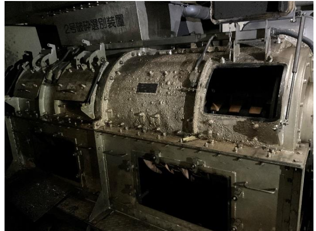
破碎選別装置の焼損状況
