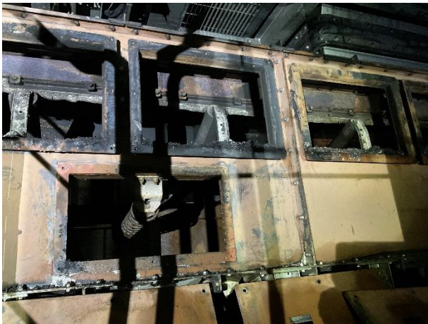
選別ごみ搬送コンベヤの焼損状況
