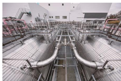
（町田市バイオエネルギーセンターバイオガス化施設の発酵槽）
