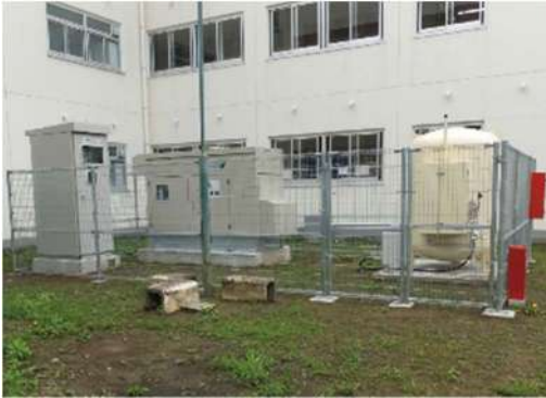
既存発電設備
