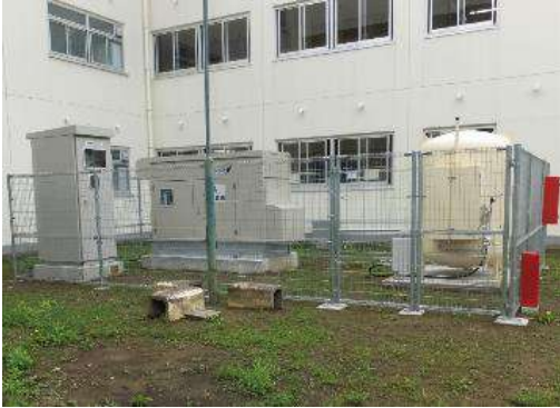
既存発電設備
