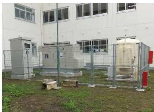
既存発電設備
