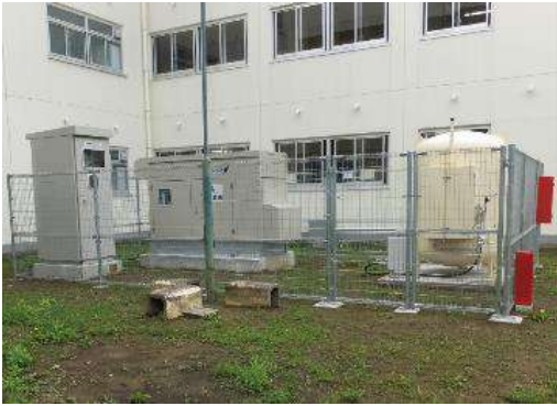
既存発電設備
