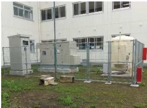
既存発電設備
