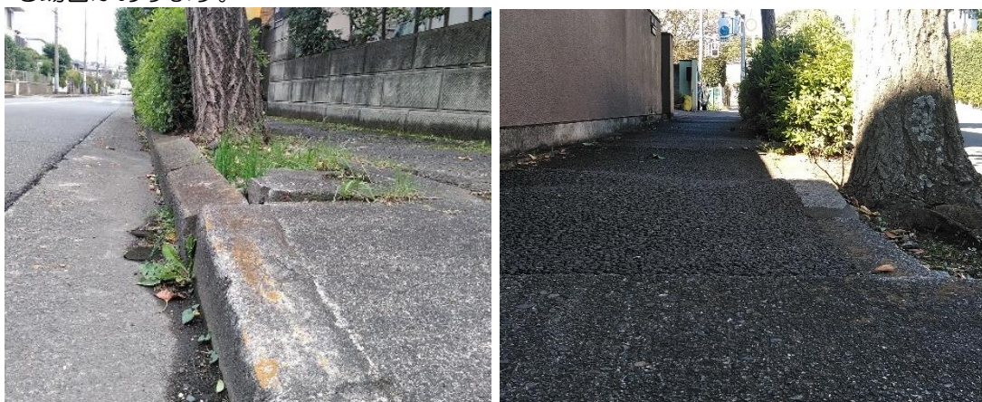
左側：車道側への根上りによる自動車・自転車の走行への支障
