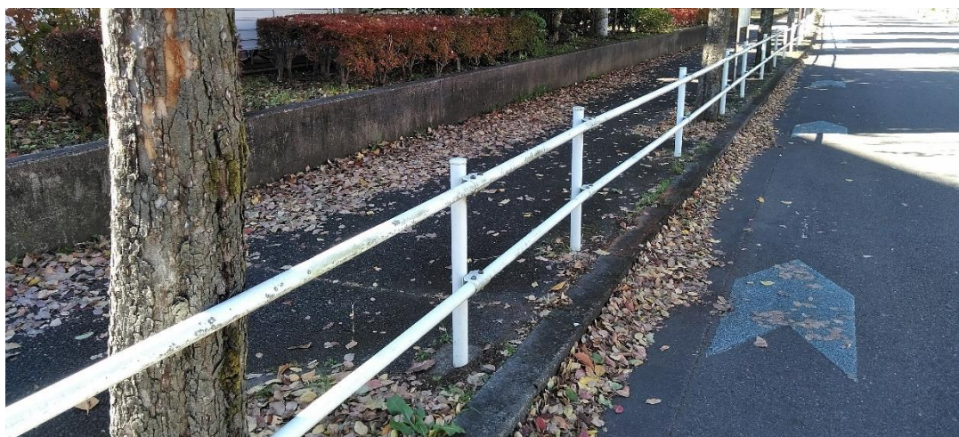
車道、歩道に落葉が堆積している状況
