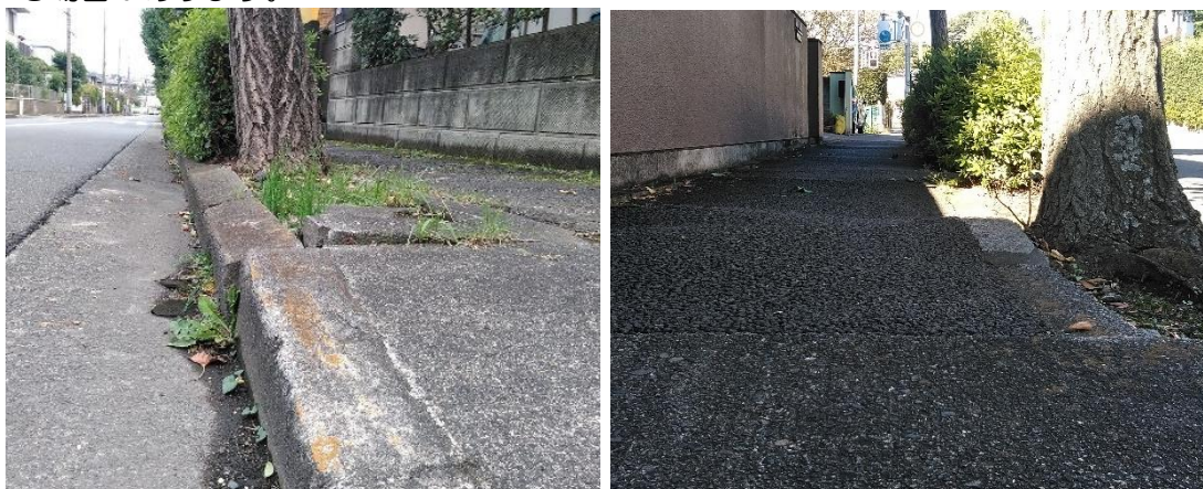
写真 左側：車道側への根上りによる自動車・自転車の走行への支障 右側：歩道の根上りによる歩行者の通行への支障
