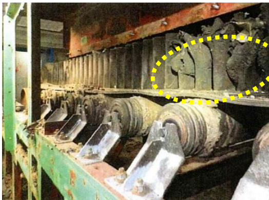
写真1 コンベヤ損傷状況①
