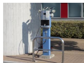
図 市庁舎設置普通充電器
